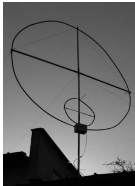
Obr. 1. Experimentální provedení MLA160, instalované provizorně ve výšce cca 7 m nad zemí a 1,5 m nad plechovou střechou.
