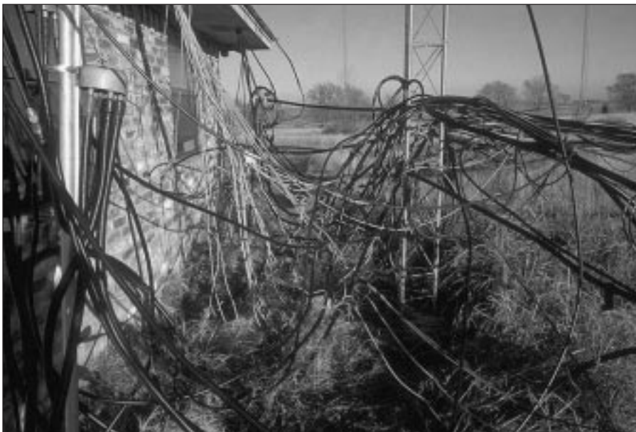
N5AU a jeho napájecí a ovládací kabeláž ke 14 stožárům s více než 30 anténami
