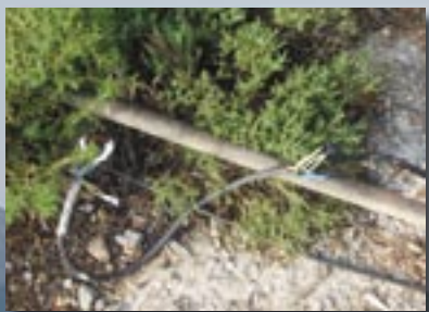
Autentický stav rozvodu elektřiny na ostrově
