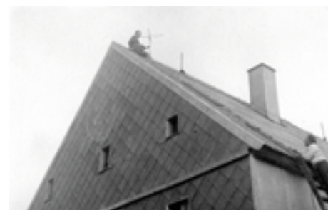
Česká bouda na Sněžce – Montáž převaděče OK0A – 14. 7. 1973. OK1AIY si nenechal ujít příležitost prorazit díru do střechy na nejvyšším místě v Čechách. Tloušťka střechy v místě byla 45 cm.
