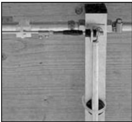
Obr. 6. Izolovaně upevněná zdíška na ráhnu s připojenou šestimilimetrovou trubkou fázovacího vedení
