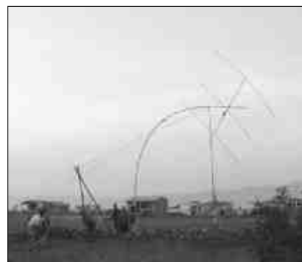
Pokládání stožáru, u kterého byly použité nevhodné kotvy s velkou pružností.
